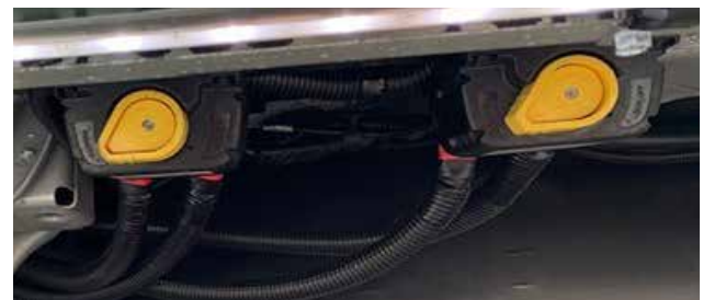
Relais de sécurité du système à batterie Li-ion
