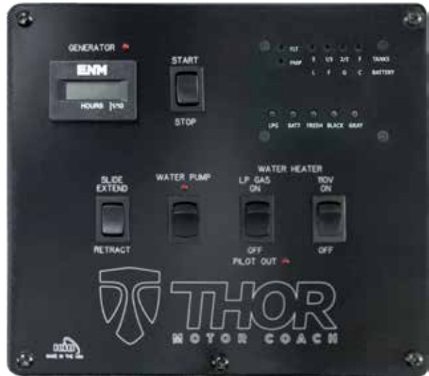
Panneau de contrôle typique. Les témoins d'état sont situés en général en haut à droite.
