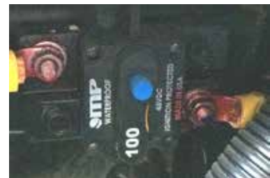
Disjoncteur typique de l'onduleur
