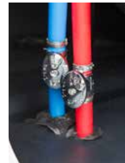
Vannes de vidange typiques à point bas
