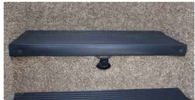
Emplacement typique de la batterie d'un autocaravanes de classe C (sous la marche d'entrée)
