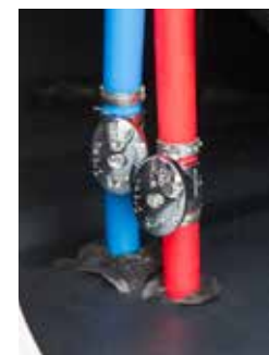
Vannes de vidange typiques à point bas
