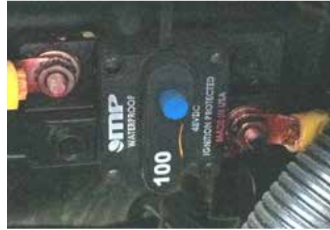
Disjoncteur typique de l'onduleur
