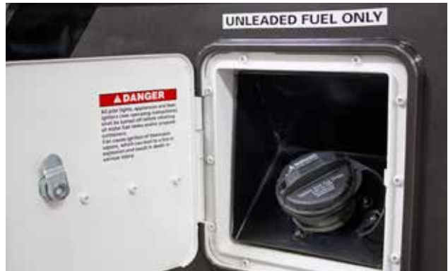
Entrée du réservoir de carburant pour le système de transfert de carburant
