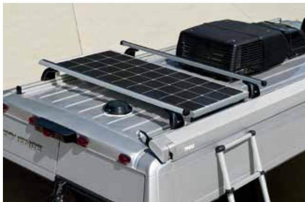
Installation typique de panneaux solaires
