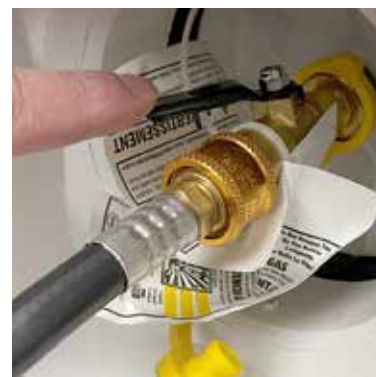
(Ci-dessus) Orifice de branchement externe typique pour le propane. (A droite) vanne d'arrêt de gaz manuelle.
