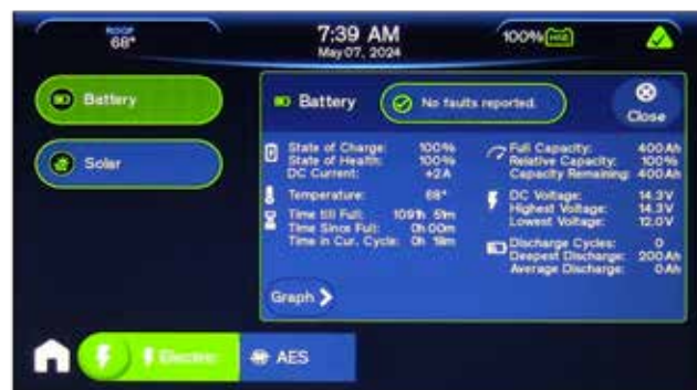
Écran de surveillance du bloc-batterie du système multiplex.
