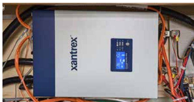
Onduleur typique installé dans un VR de classe B.
