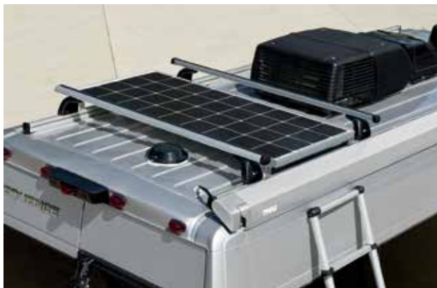
Installation typique de panneaux solaires
