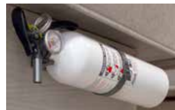
Extincteur typique de classe B-C
