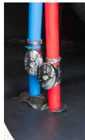
Vannes de vidange à point bas typiques
