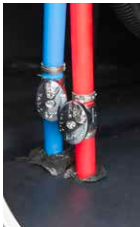
Vannes de vidange à point bas typiques
