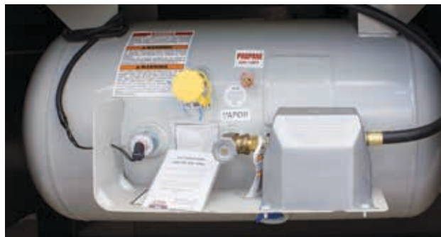
Réservoir de propane typique pour véhicules de loisirs, installé de façon permanente, avec régulateur
